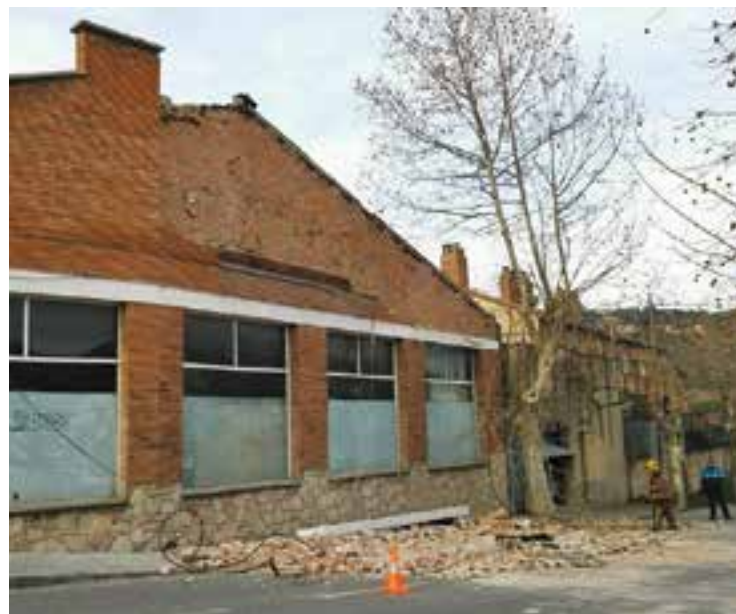
© Mur caigut a la carretera de Terrassa. || C.D.
