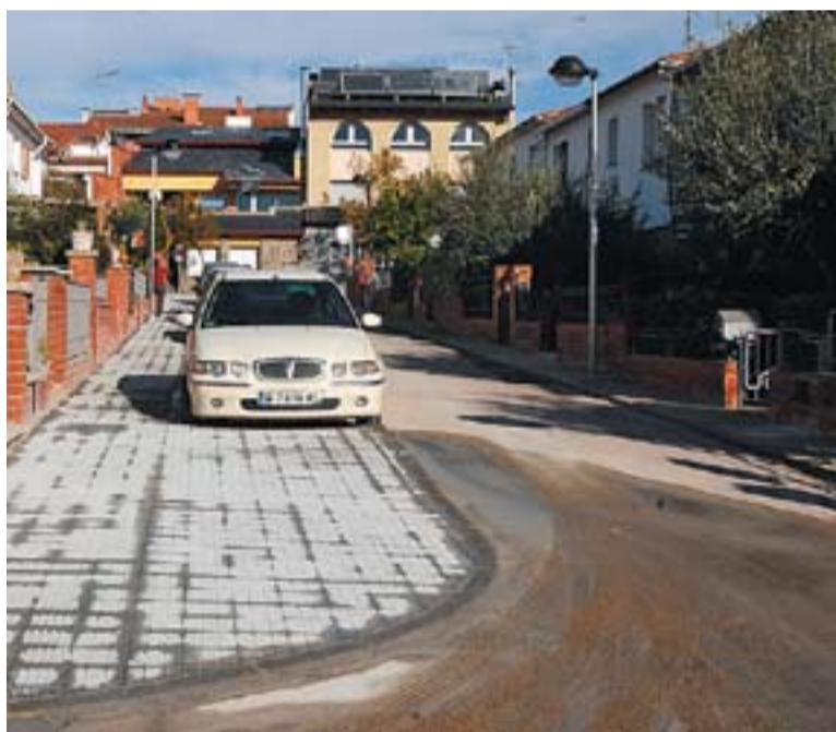
© A dalt, obres al carrer Lleida. A baix, el carrer Joan Maragall. || J. G.
